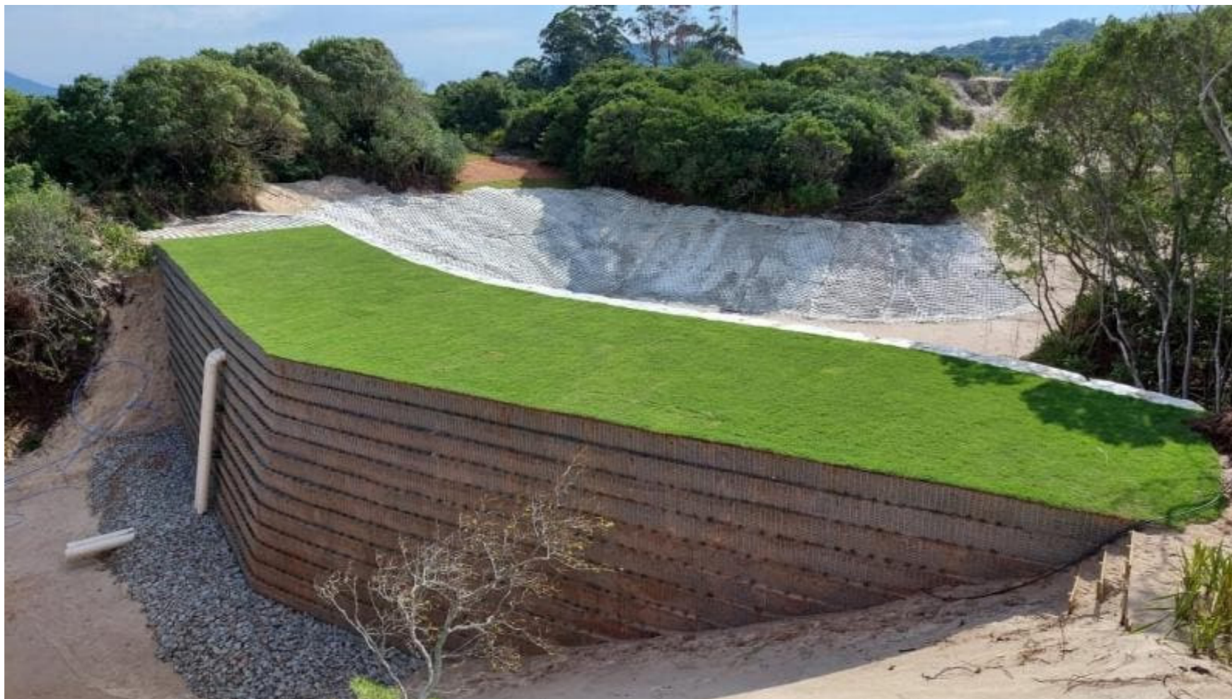
Muro de Contenção finalizado no local do desastre na Lagoa da Conceição.
