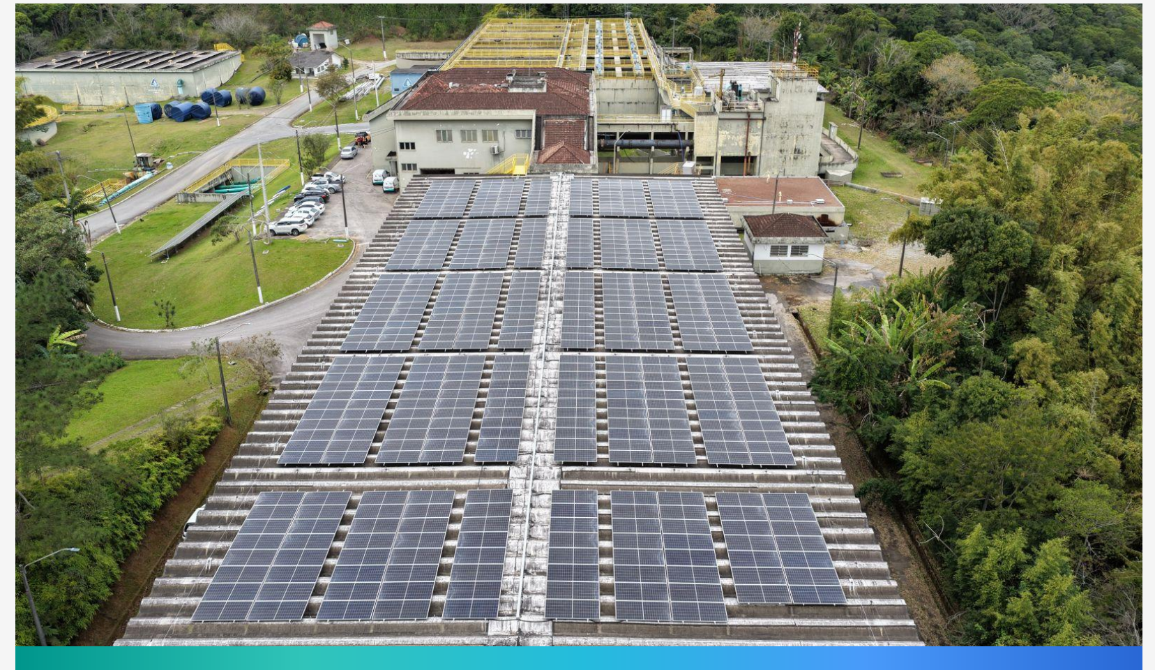
Figura 03 - Painéis instalados na ETA José Pedro Horstmann. Foto: César Carvalho/Cinemáquina.
