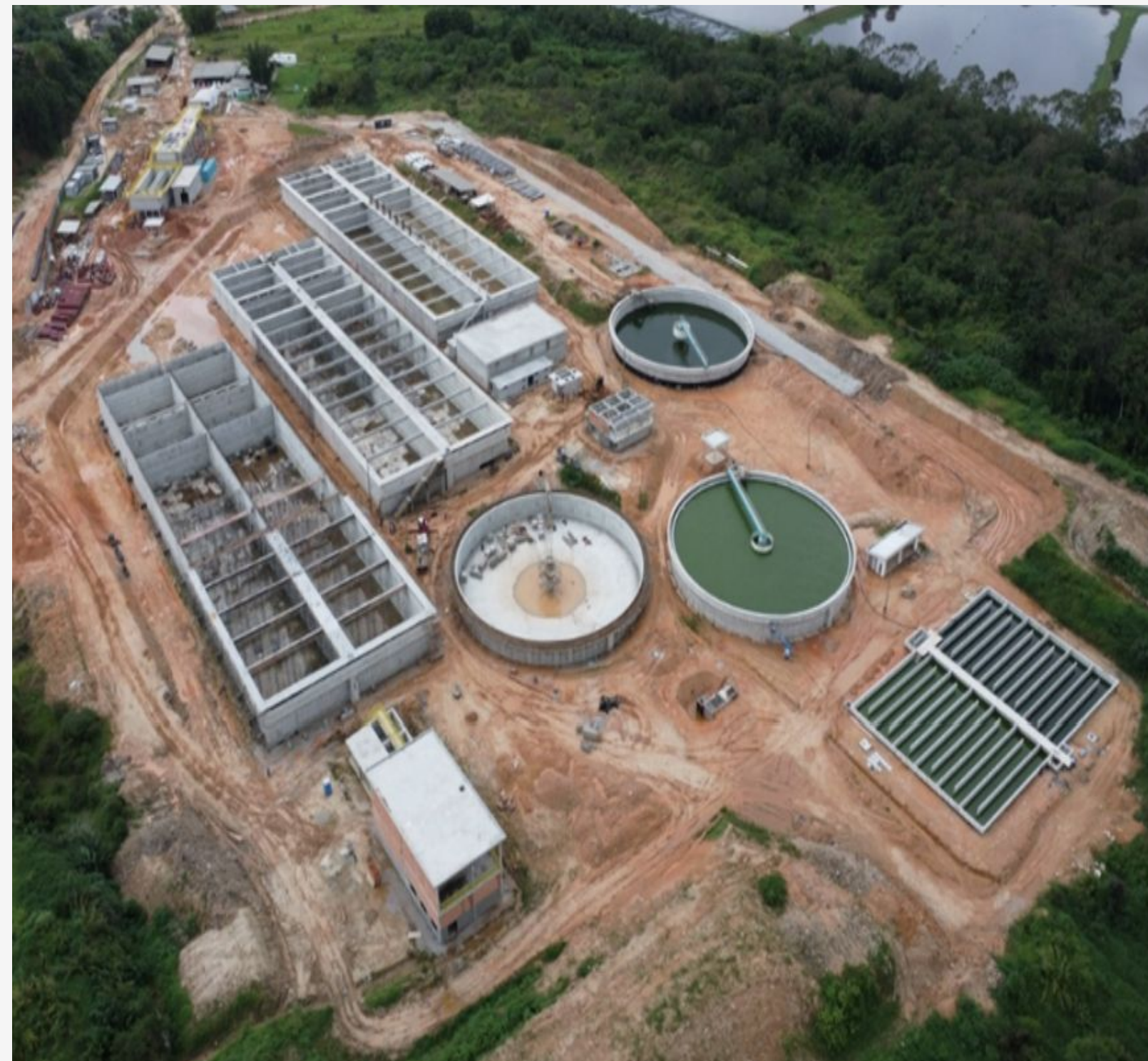
Figura 09 - ETE (Estação de Tratamento de Esgotos Potecas) - São José
